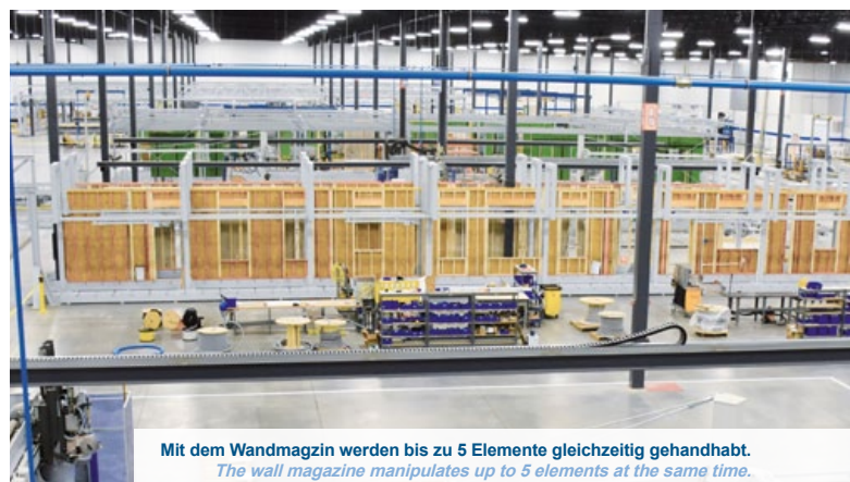
Vollautomatisches Einbringen des Dämm-Materials mit der WMS 150 blowTEC. Fully automated blowing-in of the insulation material with the WMS 150 blowTEC.
